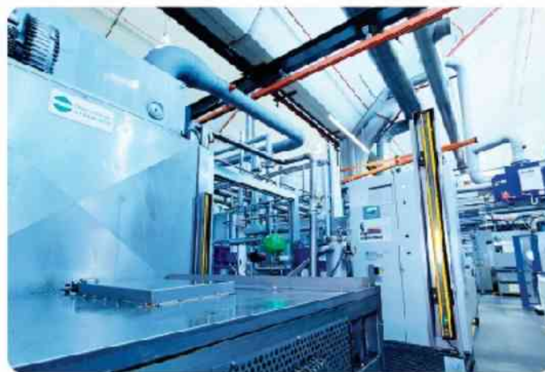
Hệ thống lưới quang an toàn bảo vệ người
